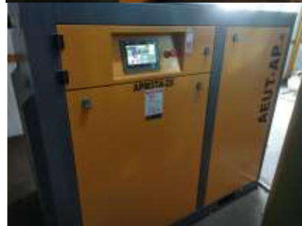
3 台 37kW 配備永磁電機及變頻功能的節能螺桿空氣壓縮機
