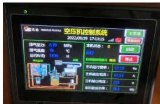
節能螺桿空氣壓縮機的操作介面
